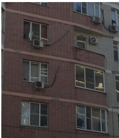
Падение и ремонт штукатурки
